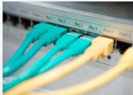
komplett neue Elektronik
